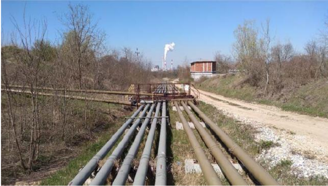
Слика 4.11 Магистрални цевоводи хидромешавине и повратне воде ТЕКО А (лево) и ТЕКО Б (десно) [49]
