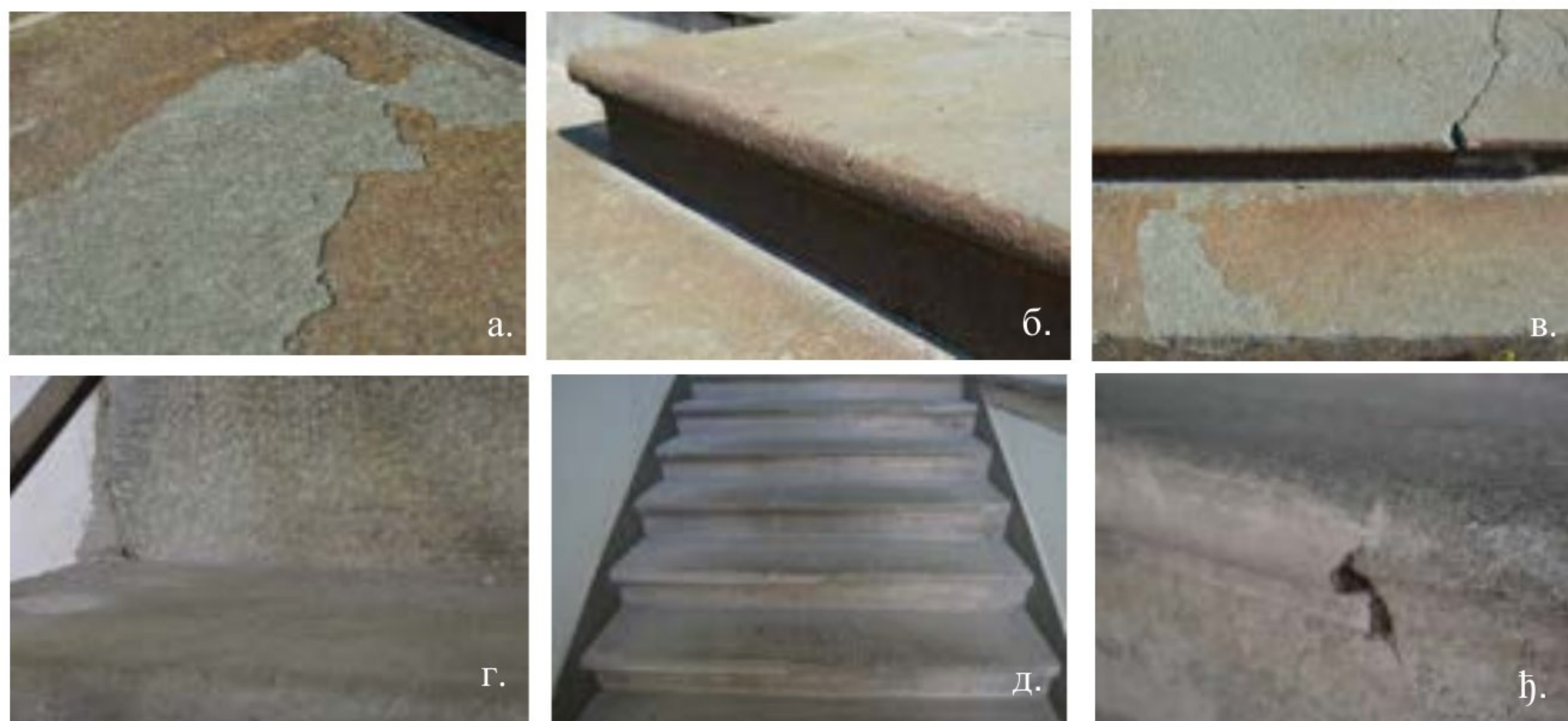
Слика 76. Прва група оштећења-губитак каменог материјала на објекту Градског правобранилаштва: а-в спољашње степениште; г-ђ унутрашње степениште; а) дубинско распадање услед одвајања љуске примарно настале површинском обрадом; б) релјефно распадање-заобљавање; в) комадасто распадање; г) дубинско распадање малог интензитета; д) релјефно заобљавање ивицегазишта степеништа; ђ) комадасто распадање на ивичним деловимагазишта
