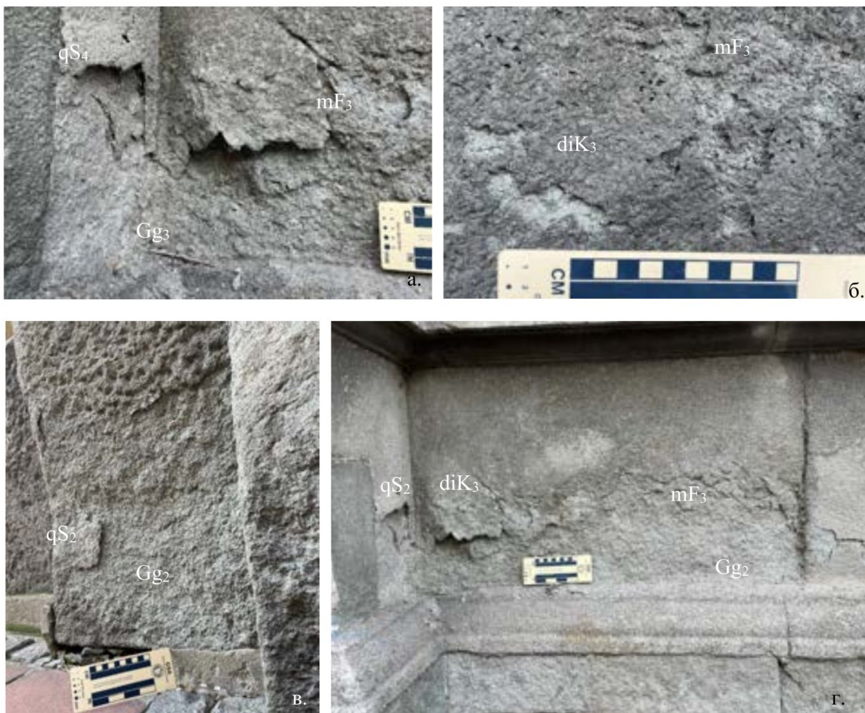
Слика 72. Форме распадања треће групе оштећења – одвајање: а) љускање и љускање; б) одвајање тамне коре, зрнаста дезинтеграција и губитак минералних конституената и последично заостале шупљине; в) љускање и зрнаста дезинтеграција; г) пример блока на којем постоји љускање, љускање, одвајање тамне коре и зрнаста дезинтеграција
