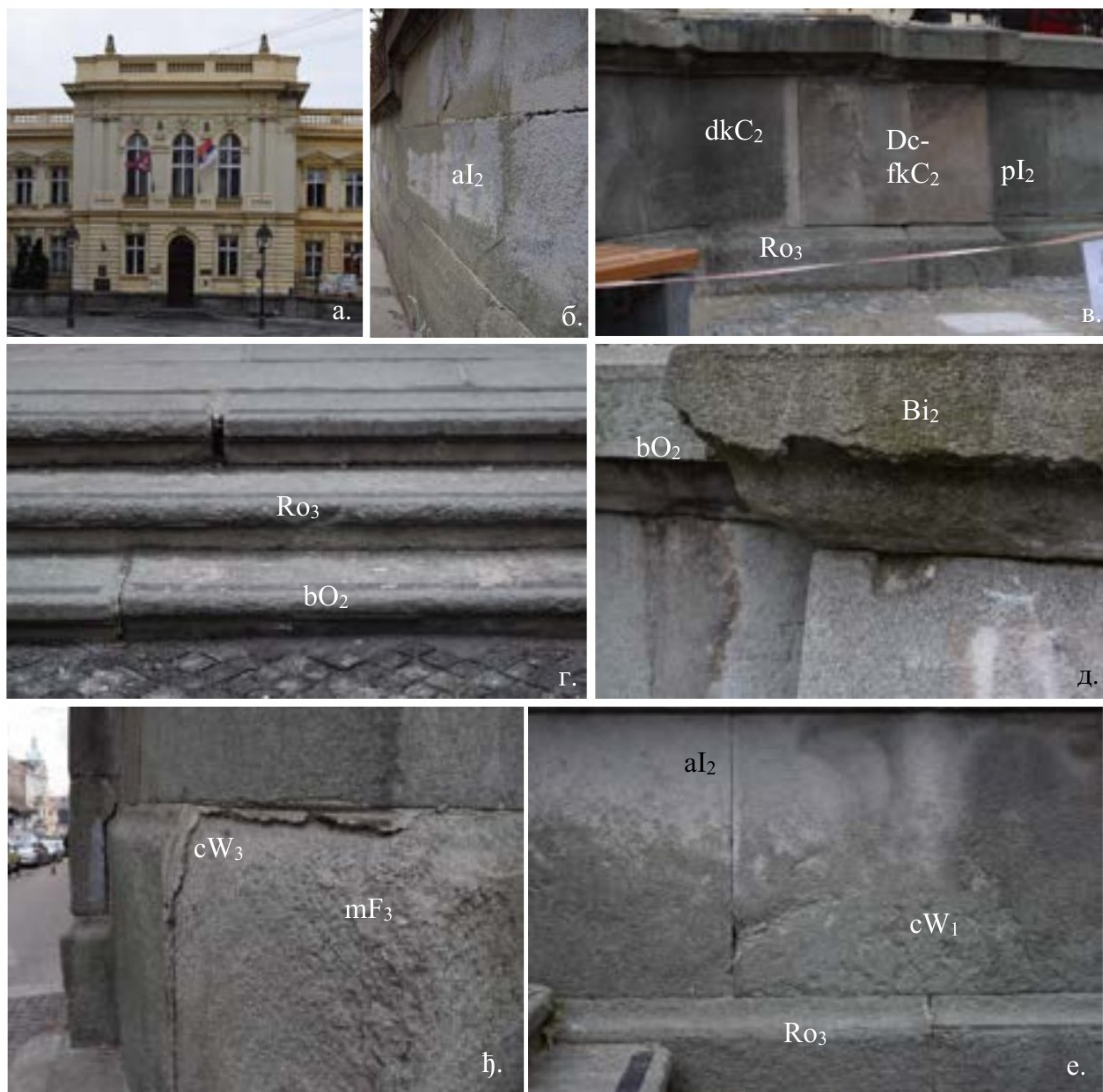
Слика 80. ОШ „Краљ Петар I“: а) општи изглед; б) запрљаност изазвана антропогеним утицајем; в) форме деградације на оградном зиду; г) заобљавање и комадасто распадање на степеништу; д) комадасто распадање ивичних профила; њ) дубинско распадање и љуспање; е) заобљавање, запрљаност и дубинско распадање на оградном зиду
