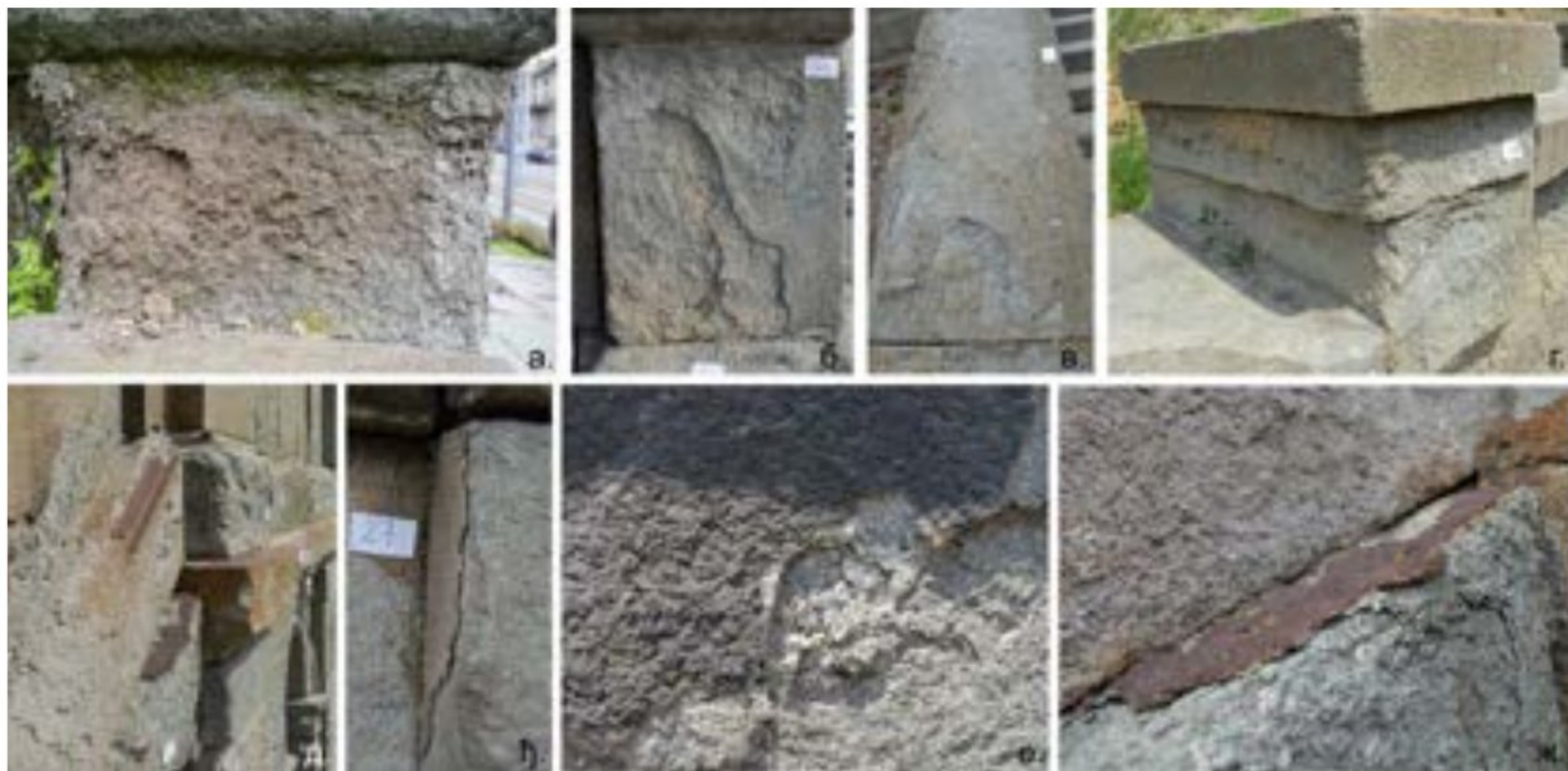
Слика 48. Трећа група оштећења-одвајање каменог материјала: а) зрнаста дезинтеграција; б) љускање на вертикалној површини стуба; в) љуспање на рукохвату; г) пример вишеструког љуспања и зрнасте дезинтеграције; д) вишеструко љуспање, одвајање обојене коре; е) одвајање обојене коре на вертикалној површини елемента; ж) комбинација вишеструког љуспања и одвајања тамне коре; з) комбинација вишеструког љуспања и одвајања обојене коре
