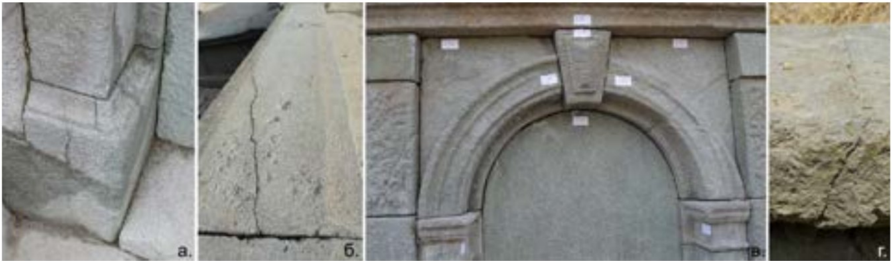
Слика 50. Четврта група оштећења-пукотине: а) мрежа пукотина на бази корита; б) пукотина на рукохвату; в) дијагонална пукотина на блоку у централном фронту са чесмом; г) пукотина целог блока покривне капе
