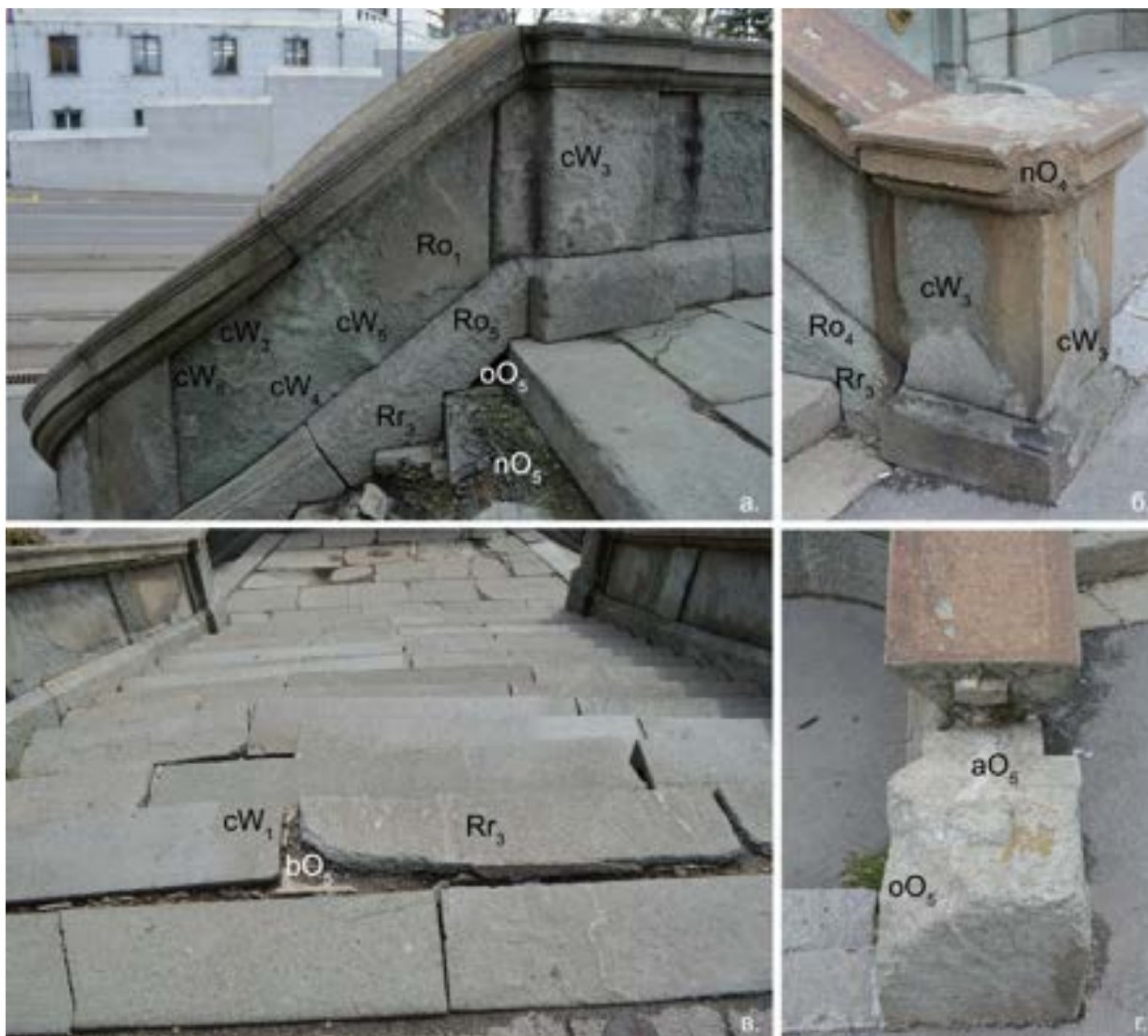
Слика 38. Прва група оштећења-губитак каменог материјала: а) дубинско распадање у различитим интензитетима, рељефно и комадасто распадање на примеру ограде и степеништа; б) пример дубинског и комадастог распадања на стубу и рељефног распадања на бази ограде; в) примери различитих типова распадања на степеницима; г) различите индивидуалне форме комадастог распадања (услед непрепознатљивих и услед антропогених фактора)
