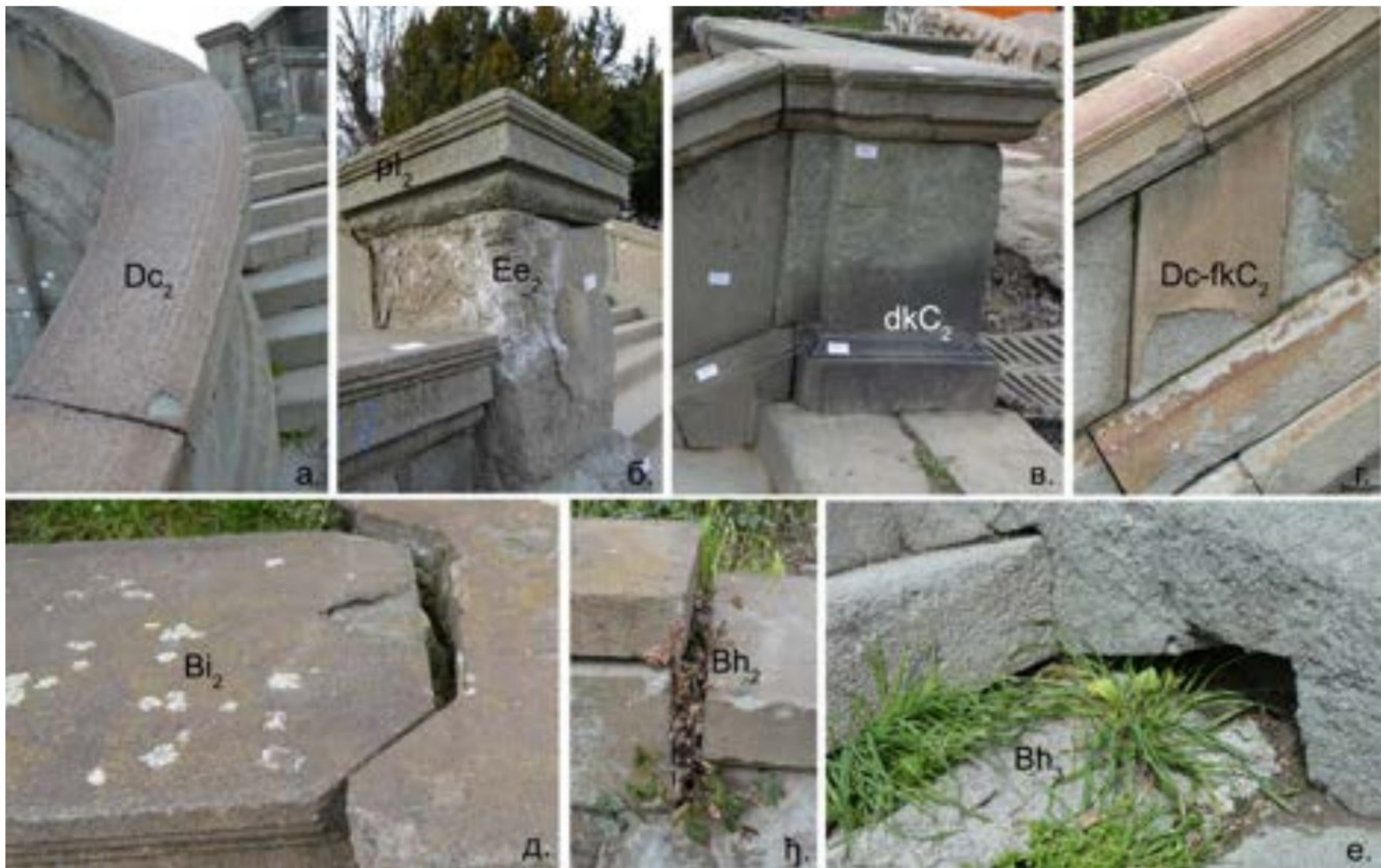
Слика 43. Друга група оштећења-деколорација/наслаге: а) обојење на горњој површини рукохвата; б) исољавање и запрљаност; в) тамна кора; г) прелазни облик између обојености и обојене коре; д) биолошка колонизација нижим биљкама; њ) биолошка колонизација вишим биљкама, корен који расте у спојници; е) биолошка колонизација вишим биљкама на степеништу
