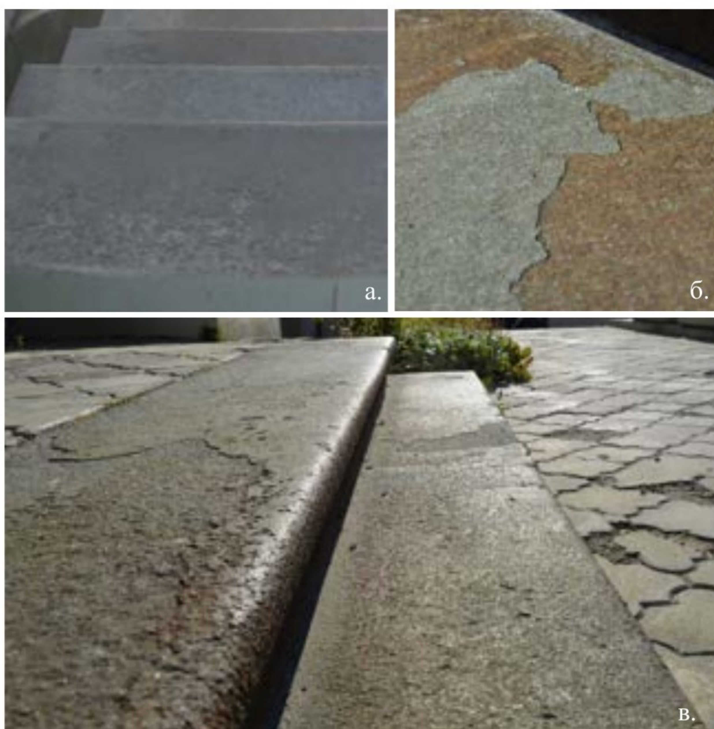
Слика 78. Форме распадања треће групе оштећења – одвајање: а) лускање; б) одвајање обојене коре која мења површину камена; в) колонизација вишим биљкама; г) зрнаста дезинтеграција и одвајање обојене коре
