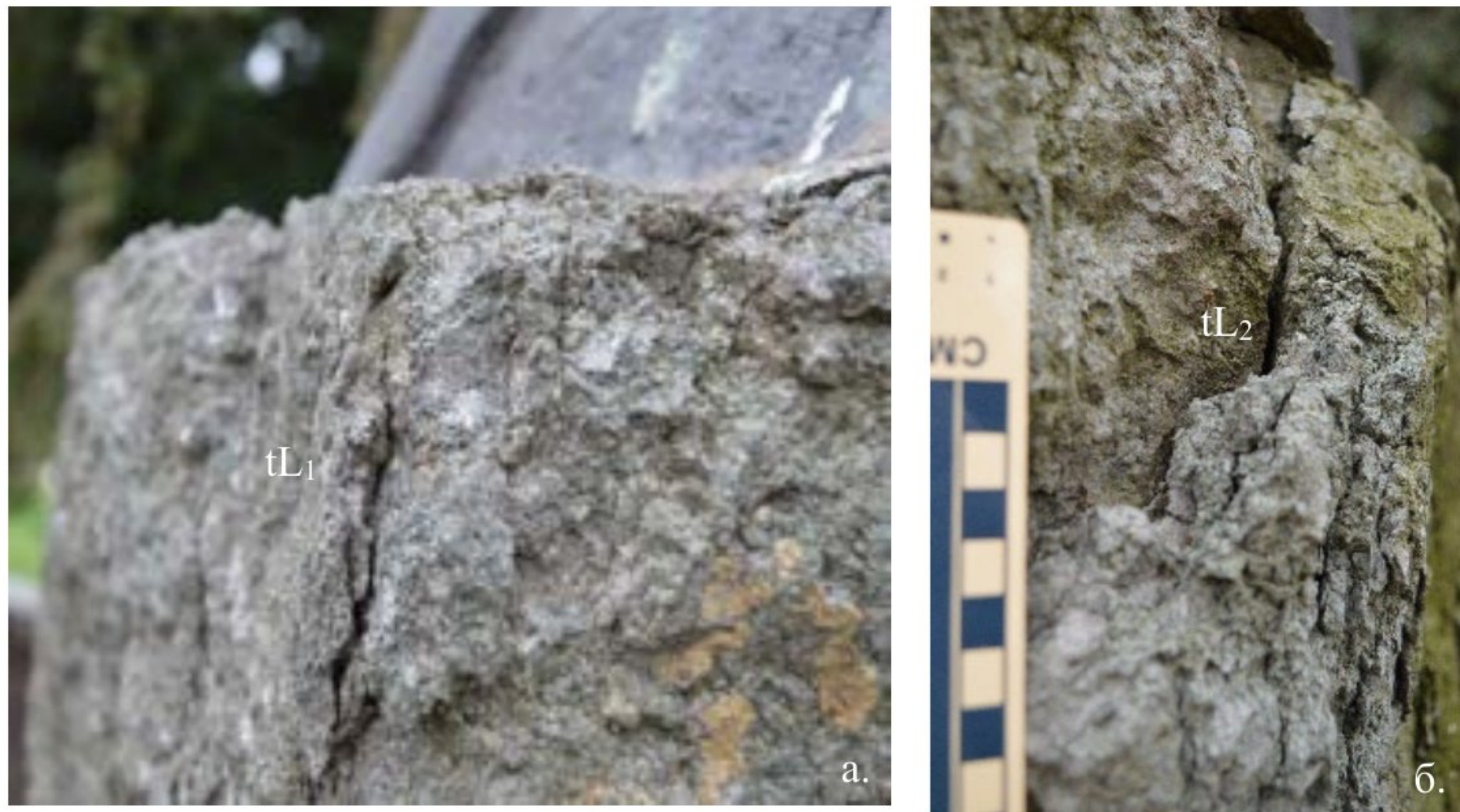
Слика 65. Четврта група распадања -пукотине а) детаљ пукотина на западној страни споменика; а) детаљ пукотина на источној страни споменика
