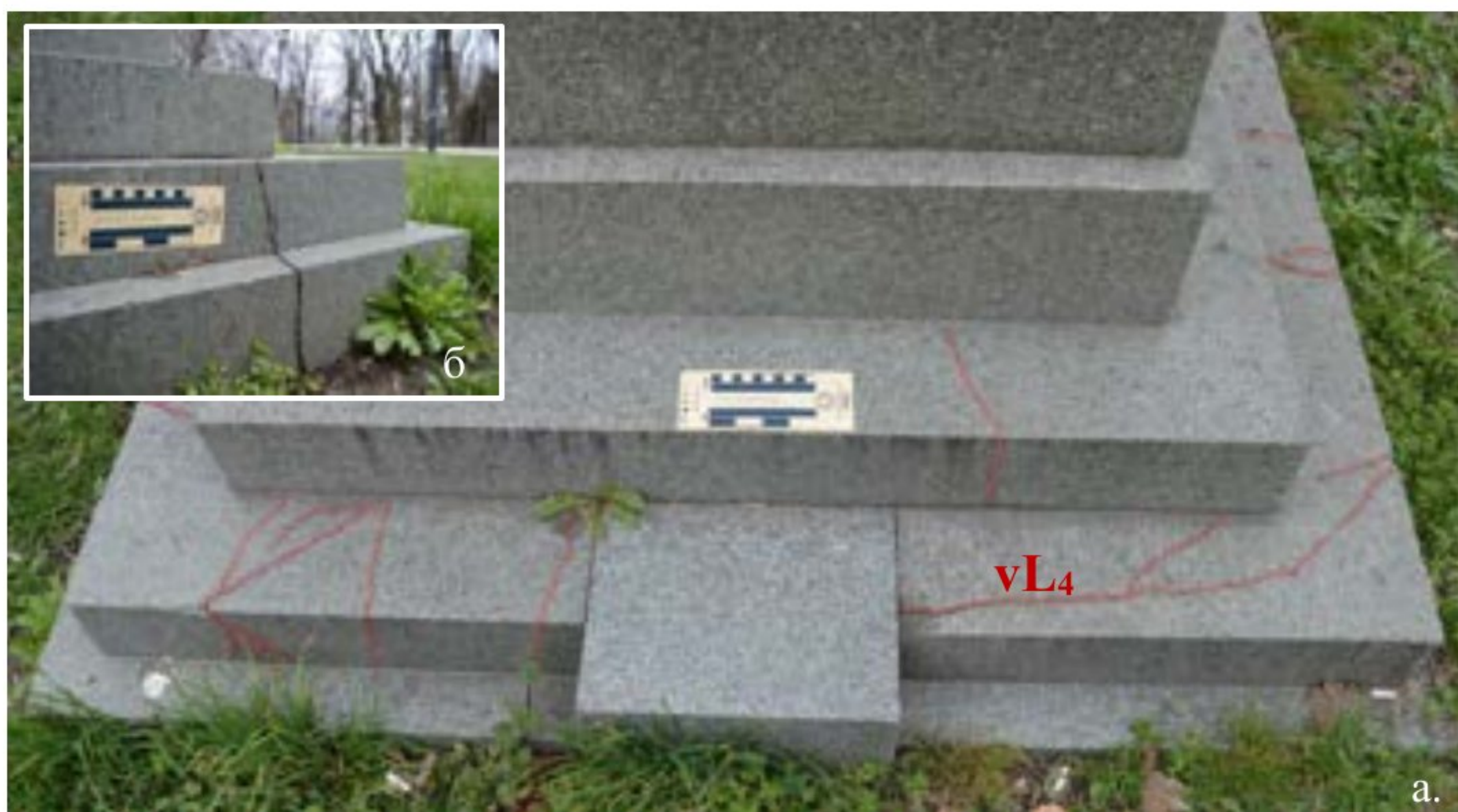
Слика 59. Пукотине на постаменту а) Диспозиција пукотина на постаменту на западној страни споменика; а) пукотине на северној страни споменика
