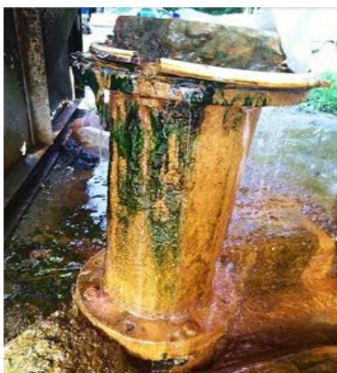
Slika 1.13 Starenje gornjih delova konstrukcije bunara u Čibutkovici
